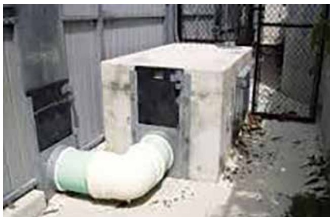
Foto 78. El uso de tubería de PVC de 40 cm o más para la comunicación entre diferentes zonas de manejo. Fuente: Duplaix et al., 2015.
